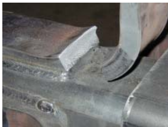
写真-6 ダンパー破断状況
