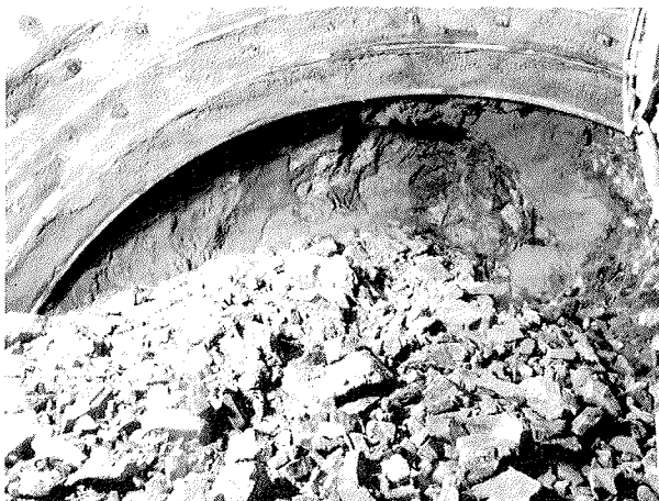
写真-1 崩落状況
