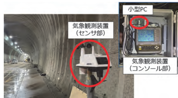
図-2 気象センサ設置状況
