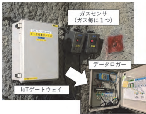
図-3 ガスセンサ設置状況
