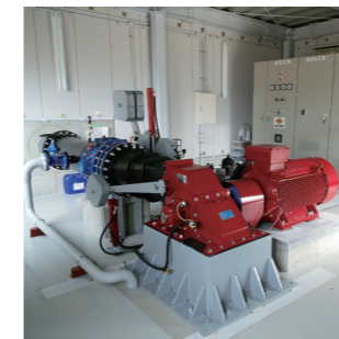
水車・発電機（定格出力136kw）
