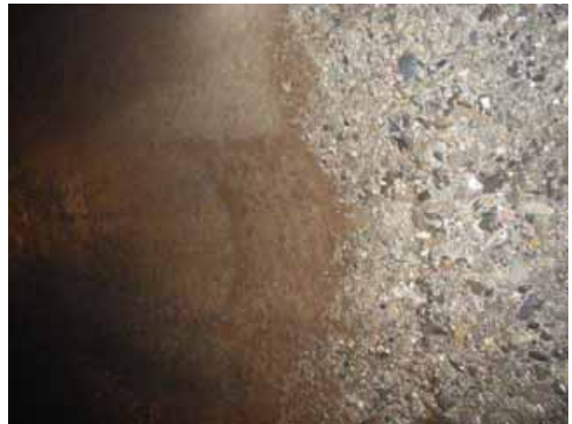
写真-3 洗浄による骨材の露出状況
