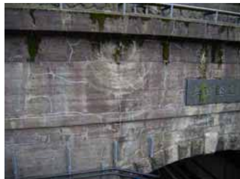
写真-1 坑口構造物（面壁）の変状
