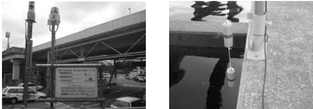
(a) 警報器とポスターの設置状況 (b) フロートスイッチの取付状況 写真-1 伝達機器の設置状況
