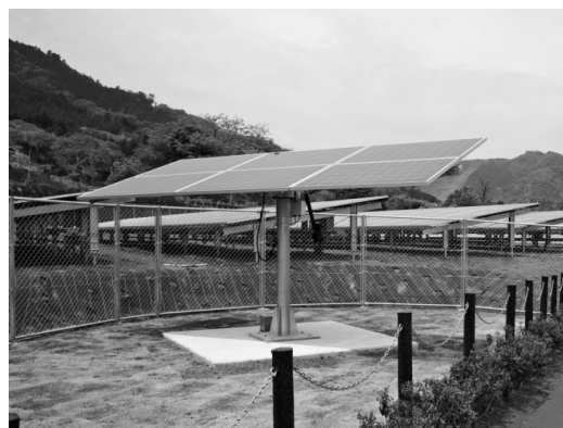
図-8 二軸追尾型発電設備
