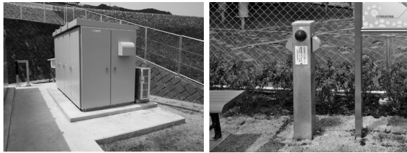
図-11 防災機能付き発電設備 (左：内部に蓄電池, 右：コンセント)
