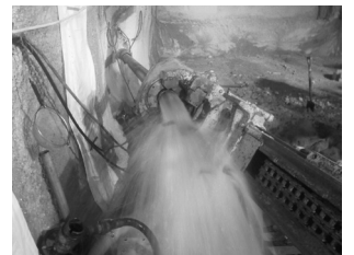
写真-2 多量湧水発生状況
