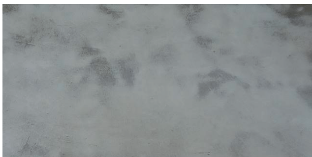
写真-3 金ごて仕上げ2回目後0.6mm/h散水の損傷状況（硬化後）
