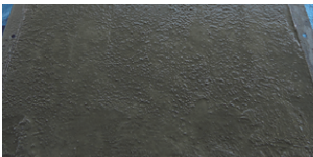
写真-1 打込み30分後0.6mm/h散水の損傷状況（散水直後）
