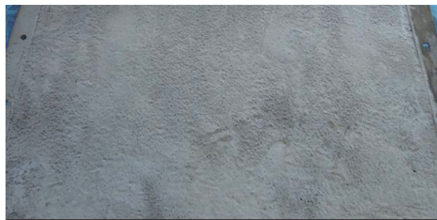
写真-2 打込み30分後0.6mm/h散水の損傷状況（硬化後）
