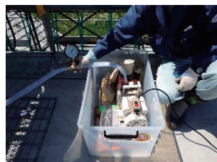
写真-3 真空ポンプ
