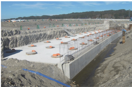
写真-1 応力遮断壁露出状況
