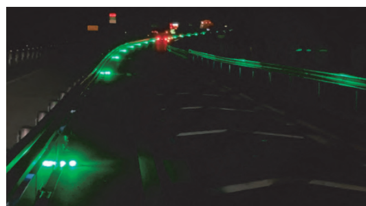
写真-9 路面誘導灯
