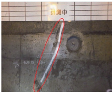
写真ー６ 側壁のひび割れ発生状況
