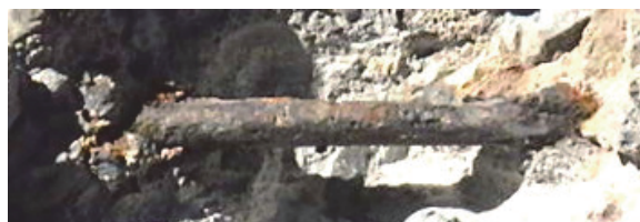
写真ー3 測定箇所の鉄筋状態
