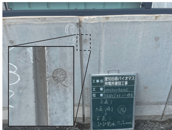
図-4 CCB工法目地内の収縮ひび割れ発生状況
