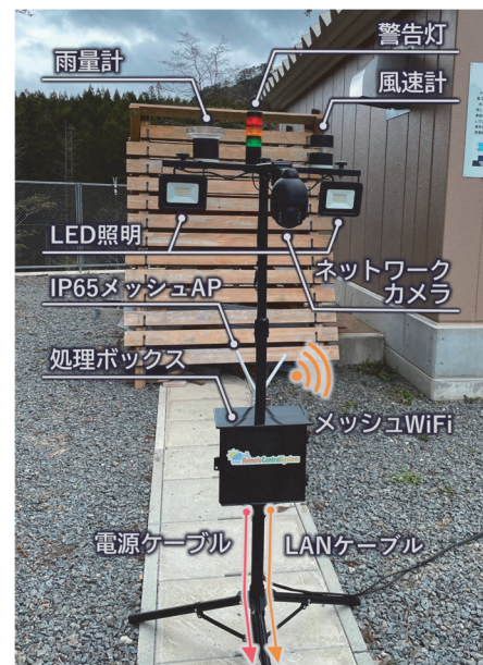
写真-6 現場に設置したリモート管制システム
