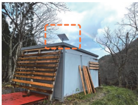
写真-4 現場に設置した衛星アンテナ
