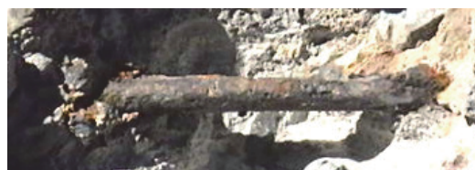
写真ー2 測定箇所の鉄筋状態
