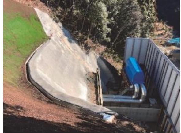
写真-7 終点側集塵機
