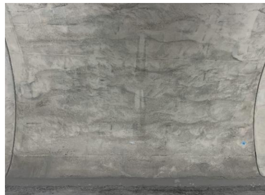
写真-1 覆工コンクリートの色むら
