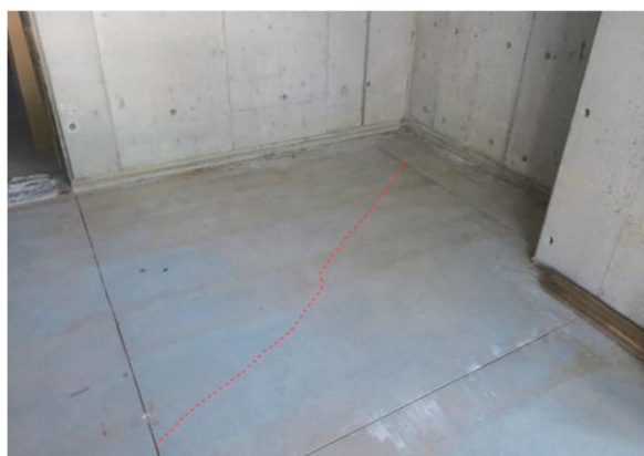
写真-2 柱周囲のひし型のひび割れ
