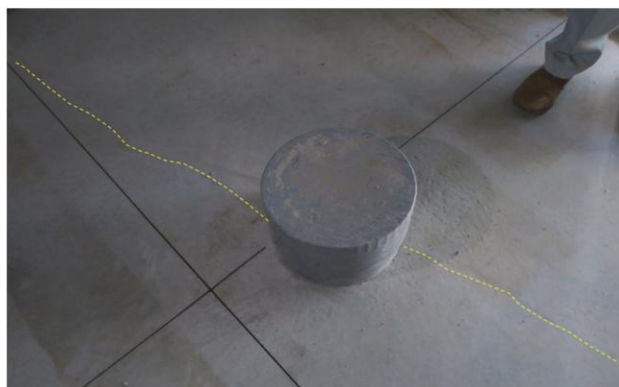
写真-4 設備配管に関連したひび割れ（中央部屋）
