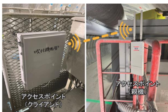
図-9 アクセスポイント設置状況
