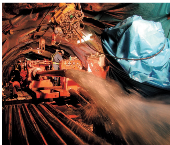
写真1 水抜きボーリングからの湧水(毎分12t)
