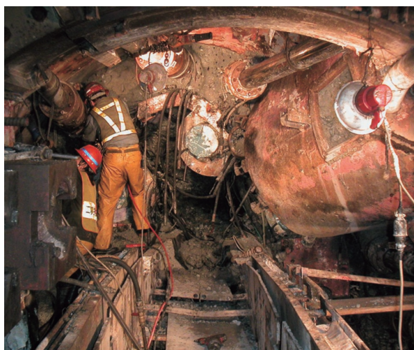
写真2 高圧流動化粘土層により破壊されたTBM
