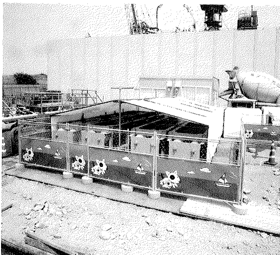
写真-5 三種混合ガス貯蔵設備
