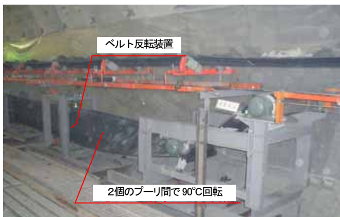
写真-6 R35m区間リターン側ベルト反転装置
