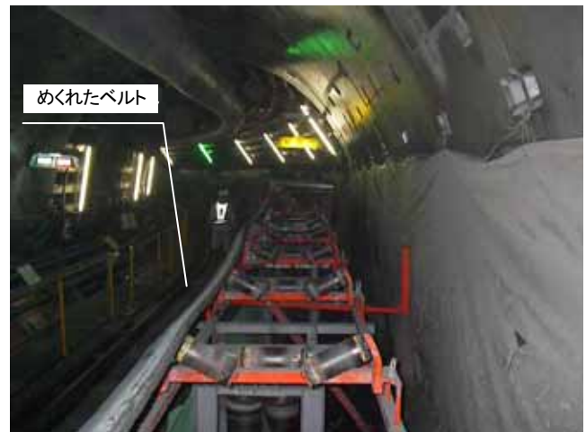
写真-11 ベルトめくれ状況2(R35m 左カーブ入口)
