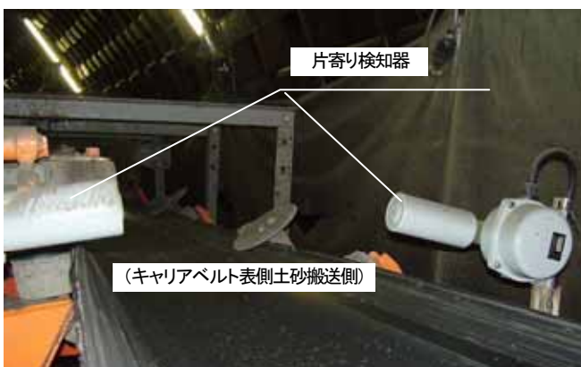
写真-12 ベルト片寄り検知器（両側設置）
