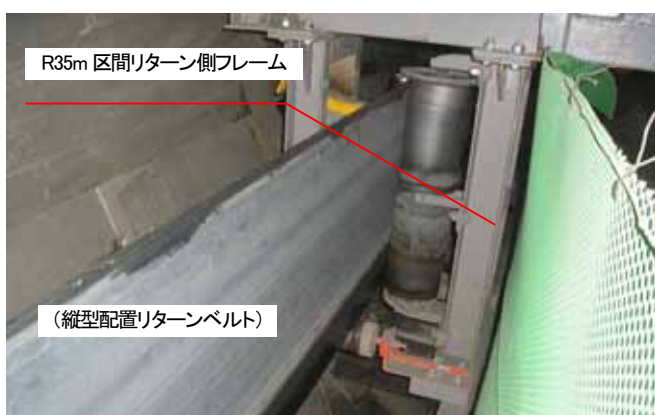
写真-7 R35m区間リターンベルト縦型配置
