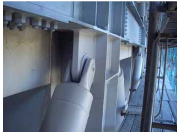
写真8 KTブレース ピン接合部
