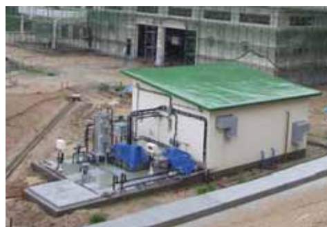
写真－9 浸出水処理設備
