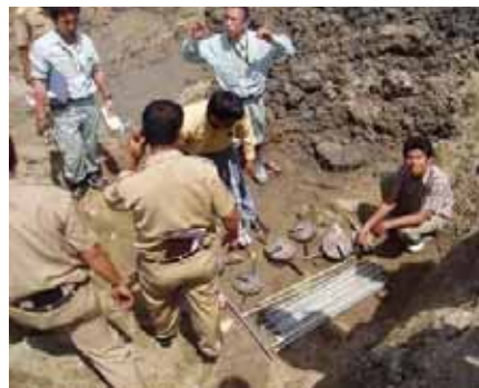
(e) ニアス島の液状化で被害を受けた埋立地での実地指導
