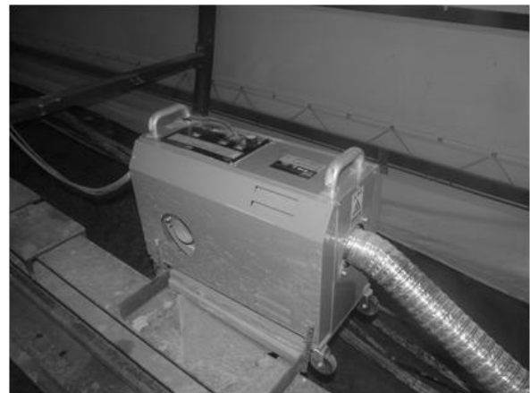
写真-4 設置した温風機
