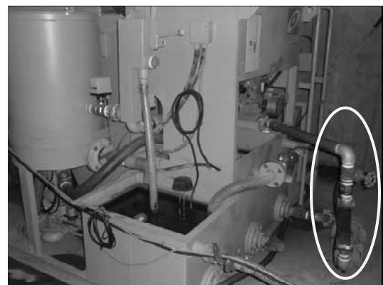
写真-7 循環攪拌ライン
