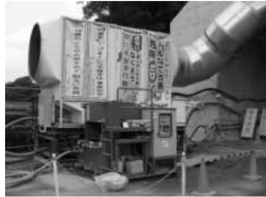
写真-2 濁水処理設備
