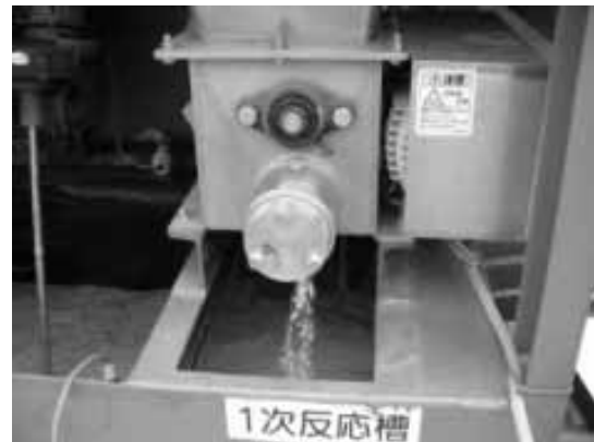
写真-3 粉末凝集剤添加装置
