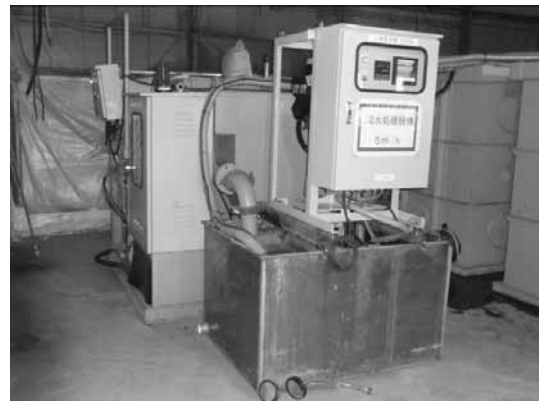
写真-6 濁水処理装置
