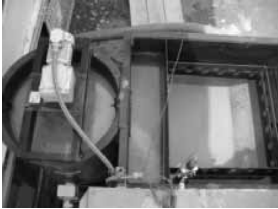
写真-5 検証時の沈降槽（左）と処理水槽（右）の状況
