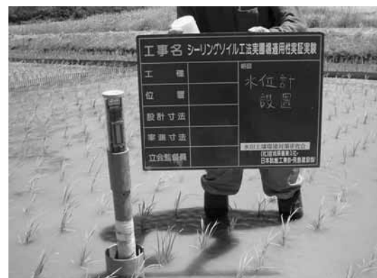
写真-1 自動水位測定器設置状況
