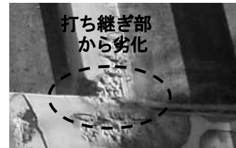
写真-2 高欄間柱基部の劣化状態
