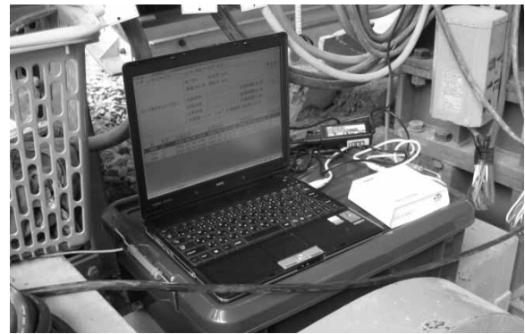
写真-3 システム設置状況
