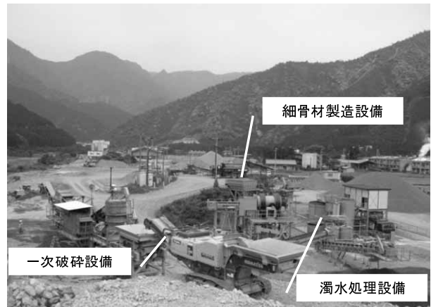
(a) 骨材製造設備全景
