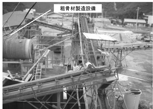
(b) 粗骨材製造設備
