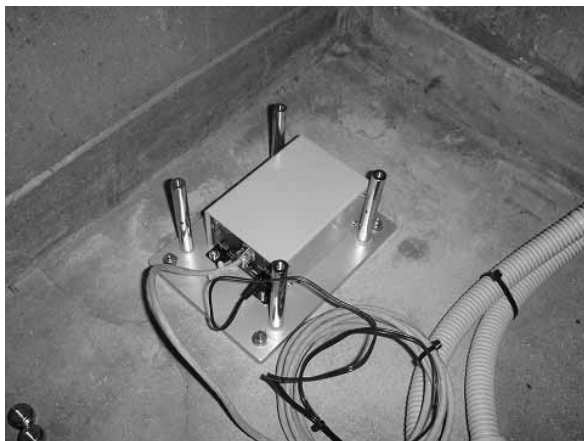
写真-4 屋上階の地震計設置状況 (地震計カバーを外した状態)
