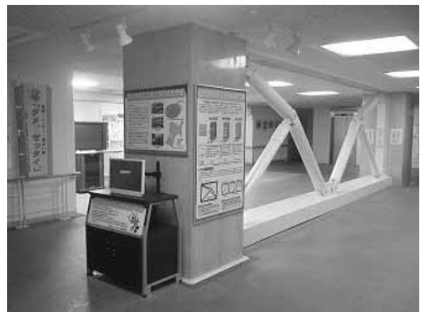
写真-3 1階ロビーに配置された増幅機構付き制震装置(トグル制震機構)と地震防災に関するパネル、および震度表示用モニター
