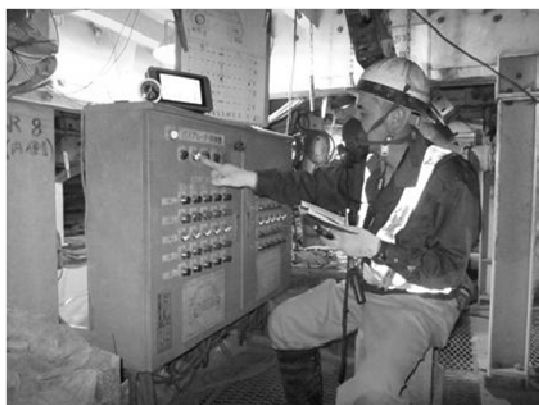
写真-1 バイブレータ集中制御盤
