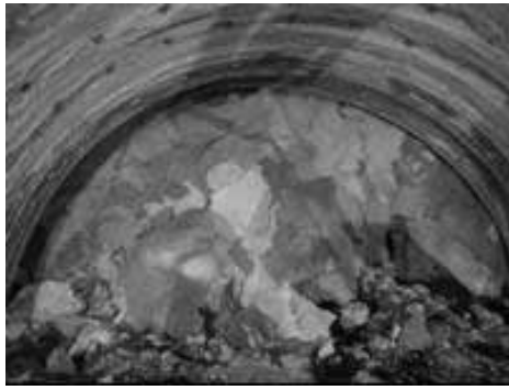
写真-1 変状区間Aの切羽崩壊
