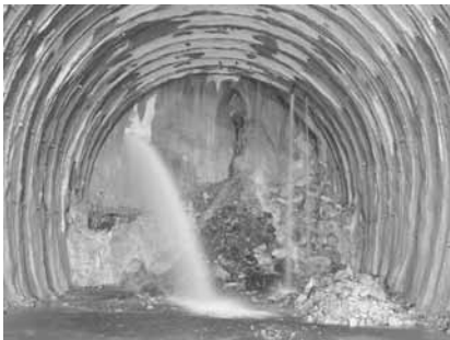
写真一 塊状地山の崩壊例
