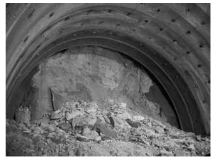
写真三 軟質地山の崩壊例
