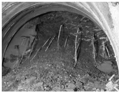
写真二 層状地山の崩壊例
