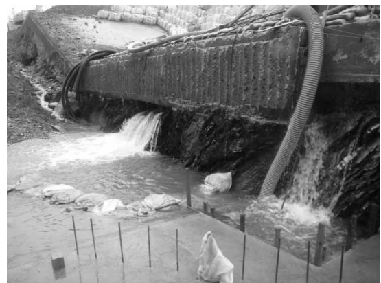
写真-2 湧水状況
