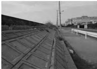
写真-19 堤防の変形
