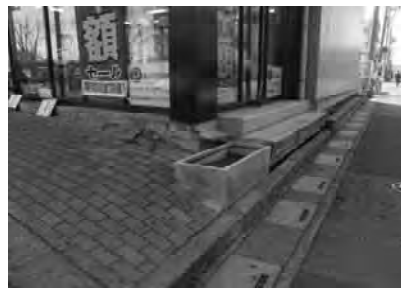
写真-41 越谷市千間台西 沈下が進行
