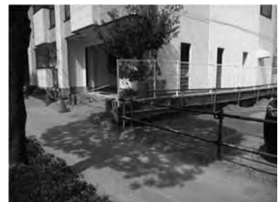
写真-3 建物周囲の地盤沈下
