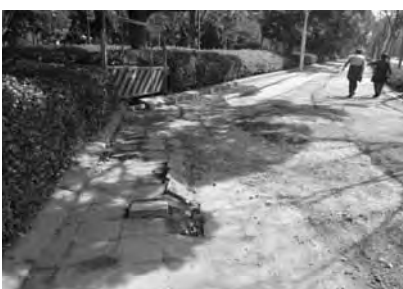
写真-8 ブロックの座屈、歩道の仮修復あと
