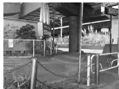
写真-14 臨海公園付近の液状化
