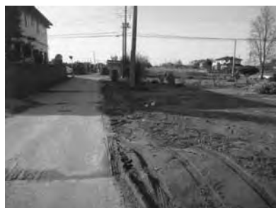
写真-37 噴砂と道路の亀裂・沈下・変形
