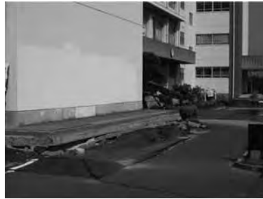
写真-17 大型構造物周辺の沈下
