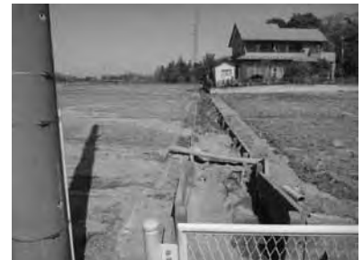
写真-30 民家の変形, 水路の変形, 噴砂の堆積
