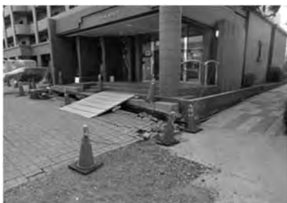
写真-1 建物周囲の地盤の沈下
