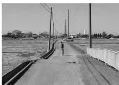
写真-29 道路の沈下
