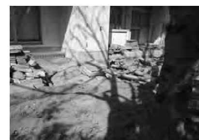
写真-12 建物周囲の沈下、配管の仮復旧
