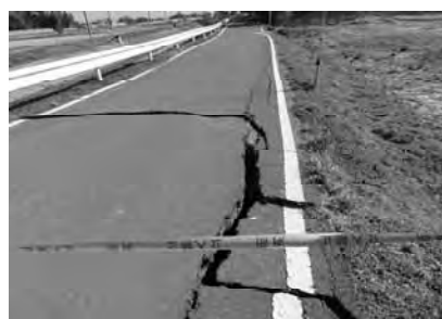
写真-39 道路の亀裂、段差
