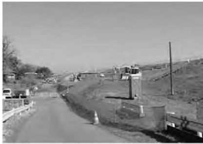
写真-25 河川堤防斜面の流動
