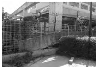
写真-2 駐車場周囲の地盤沈下
