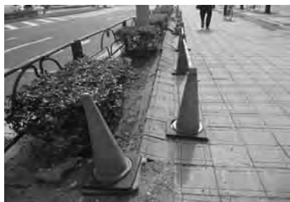
写真-7 歩道ブロックの座屈
