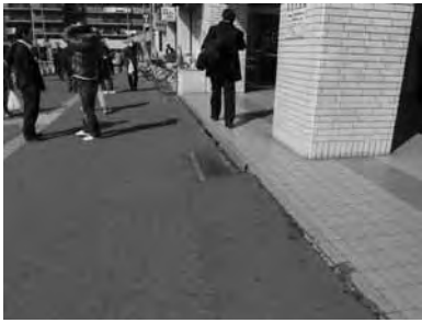
写真-40 越谷市千間台西 沈下が進行
