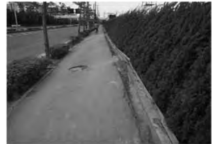
写真-21 歩道の盛り上がり
