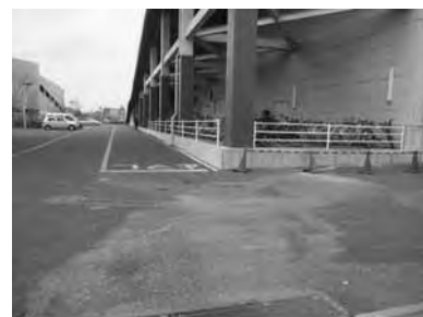
写真-15 東葛西の液状化(建物周囲の沈下)
