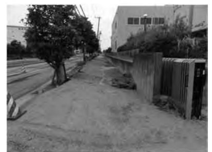
写真-24 道路の沈下、亀裂、段差
