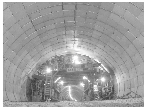
写真-3 EPSパネルを用いた覆工コンクリートの養生状況
