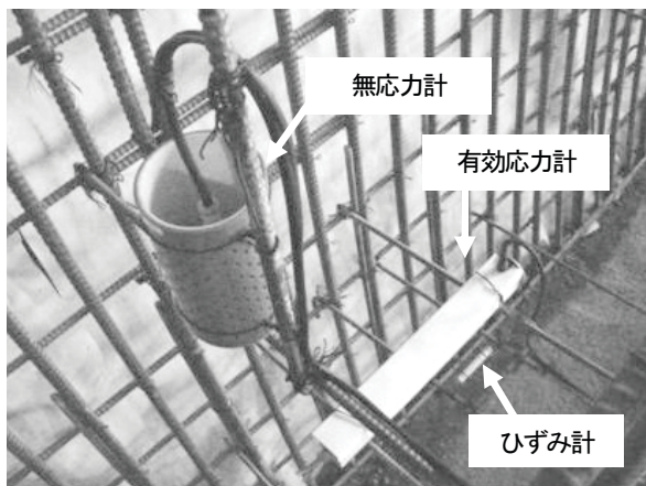
写真-2 計測器設置状況 (脚部)
