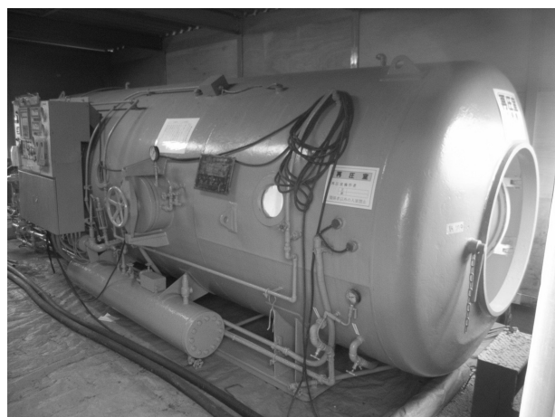
写真-1 再圧室の外観
