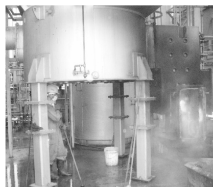
写真-14 溶融炉と出滓状況
