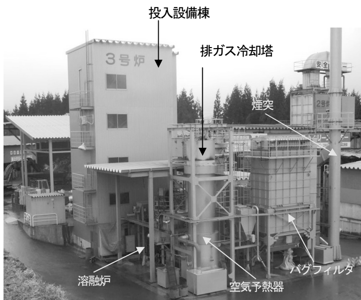
写真-10 実証試験（兼 事業化）プラント全景
