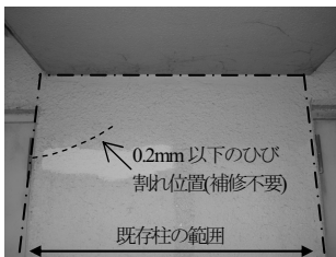
写真-2 ひび割れが生じている既存柱の一例
