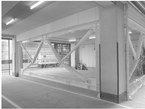
写真-1 Mビル装置設置後
