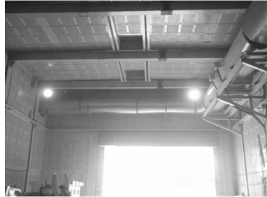
写真-5 防音ハウス内に設置したコントラファン
