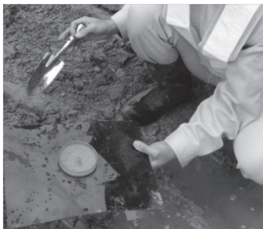
写真－2 処理土の油分確認（油膜確認状況）
