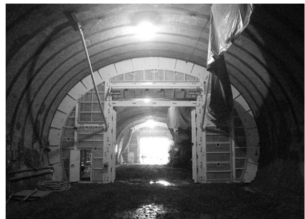
写真-2 切羽より見た坑内設置の防音扉
