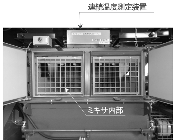
写真-1 ミキサ内の温度測定システム
