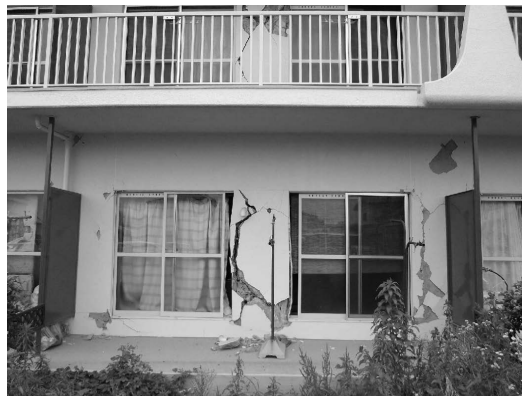
写真-1 非耐力壁の被害状況
