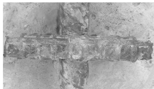
写真-2 No.18 の鉄筋腐食状況 (鉄筋かぶり 13mm)
